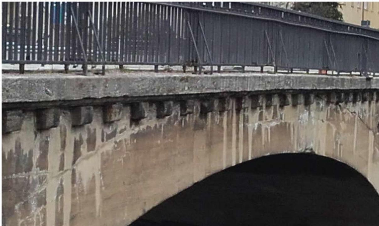
Abb. 11 - Karlsbrücke vor der Sanierung
