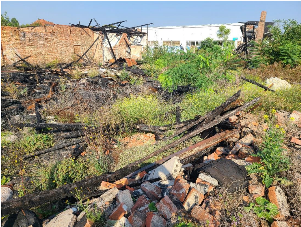
Abb. 2: Gebäuderuinen (unterkellert, wurden nicht betreten)
