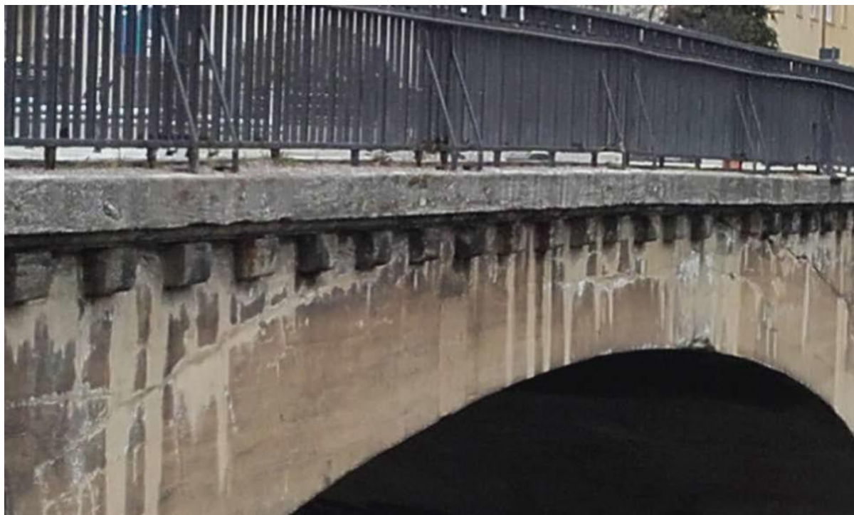
Abb. 11 - Karlsbrücke vor der Sanierung
