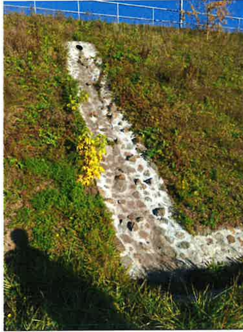
Beckenzulauf offener Abschnitt
