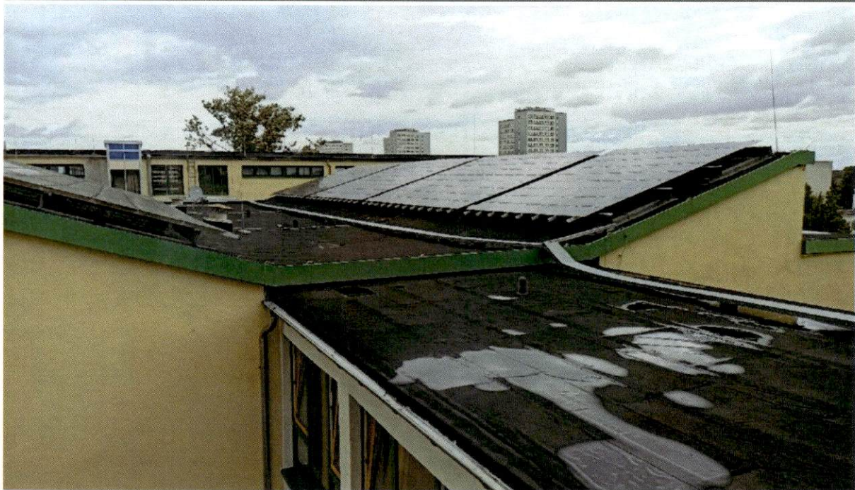
Abbildung 16 Sanierungsbedürftiges Flachdach Typenbau
