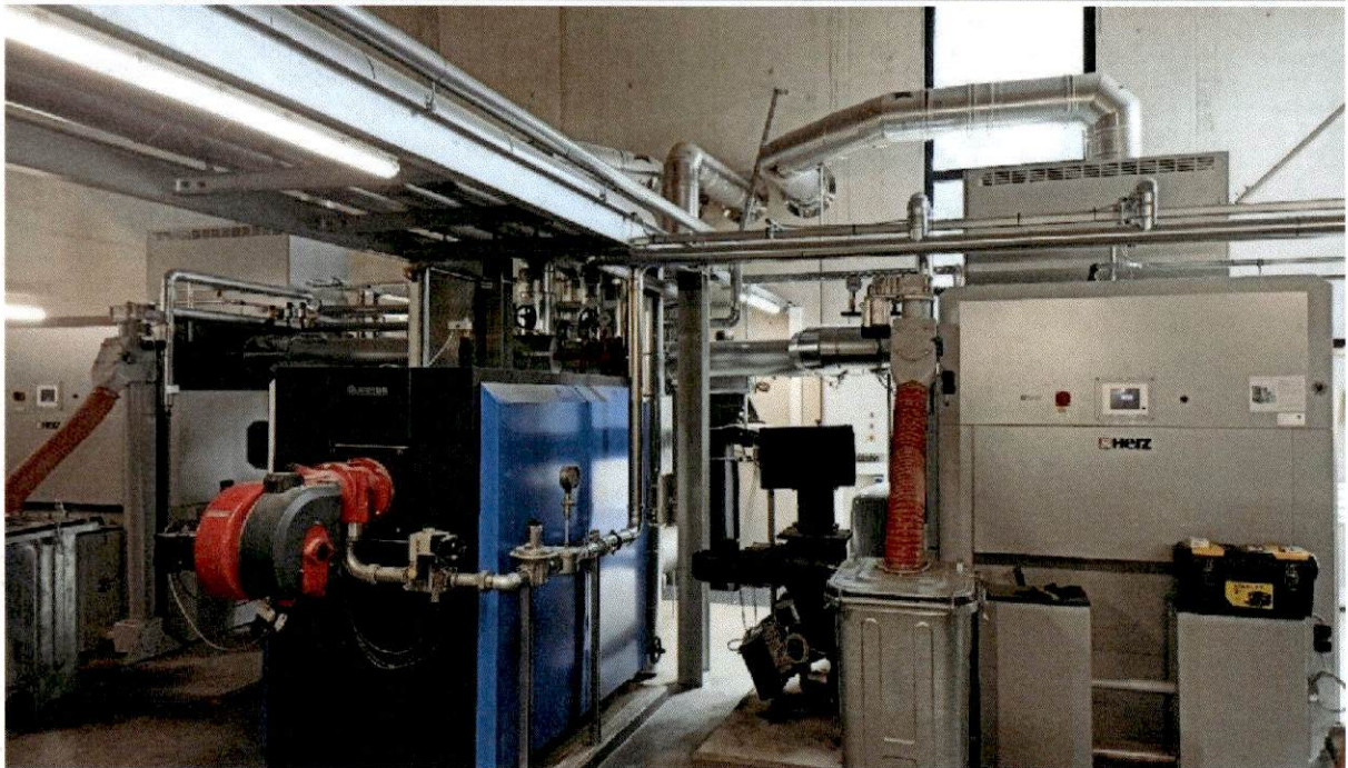
Abbildung 55 Hackschnitzelheizung mit Gasbrenner (2023)
