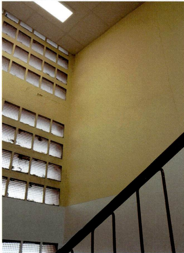
Abbildung 4 Brandschutzmängel im Rettungsweg
