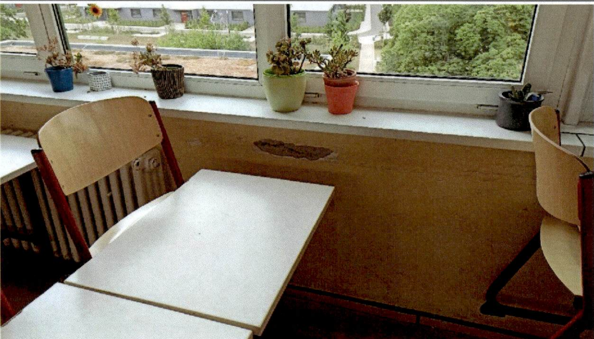
Abbildung 19 Putzabplatzungen im Klassenzimmer
