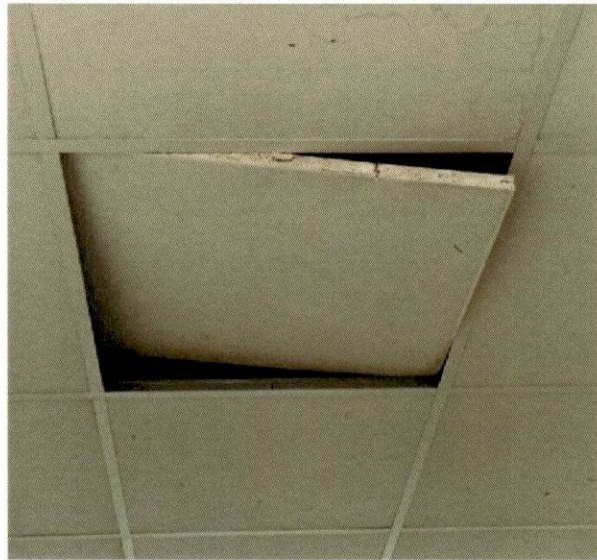
Abbildung 3 Lose Elemente in der Abhangdecke
