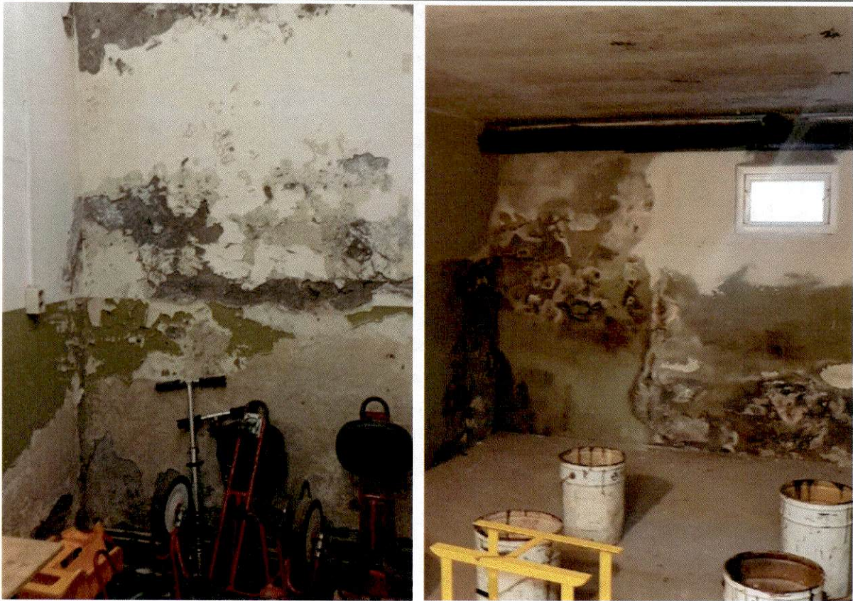
Abbildung 20 Durchfeuchtete Wände im Bestandskeller
