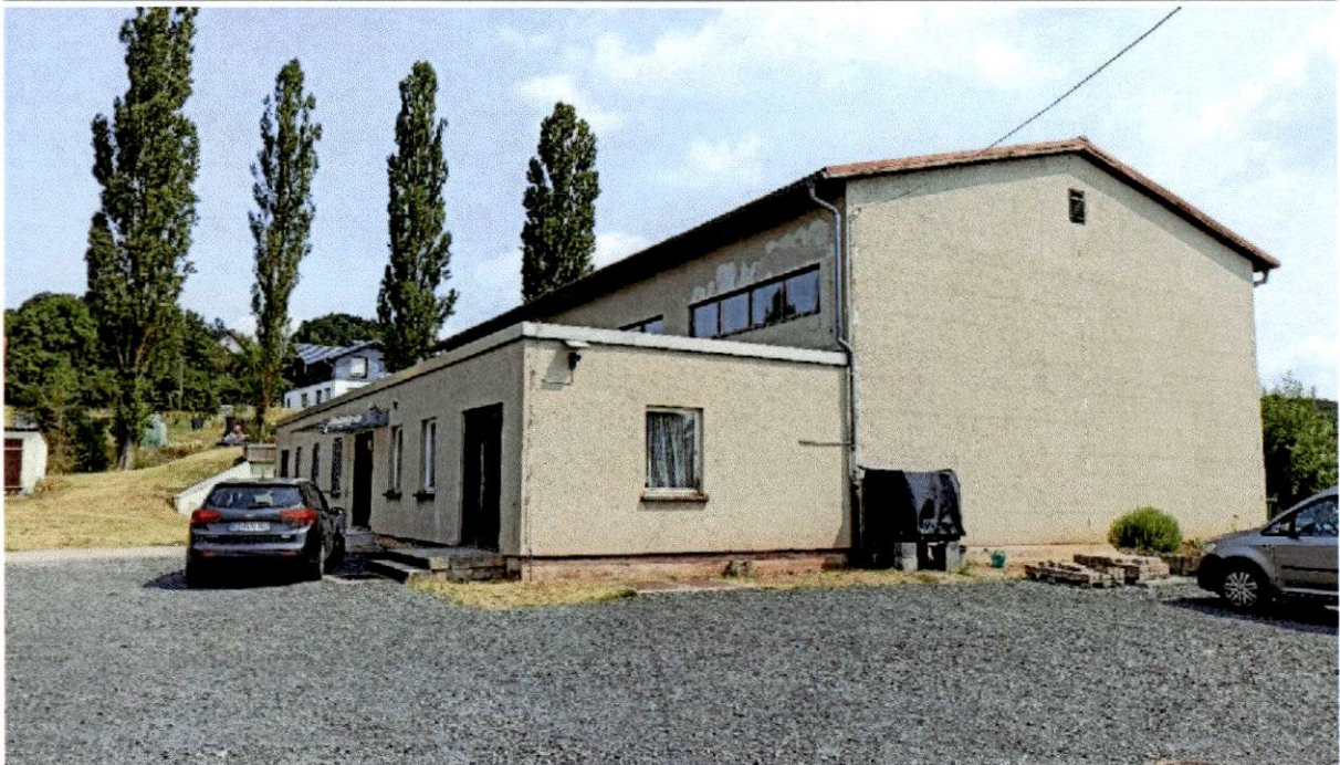
Abbildung 34 Turnhalle mit hohem Sanierungsbedarf
