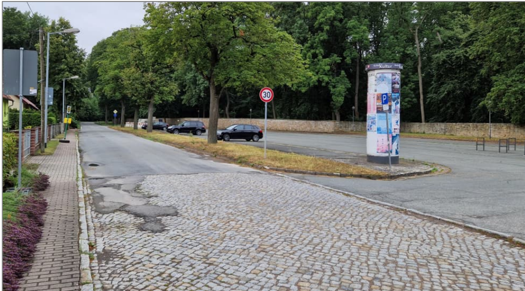
Abb. 4 Grenze Asphalt / Natursteinpflaster
