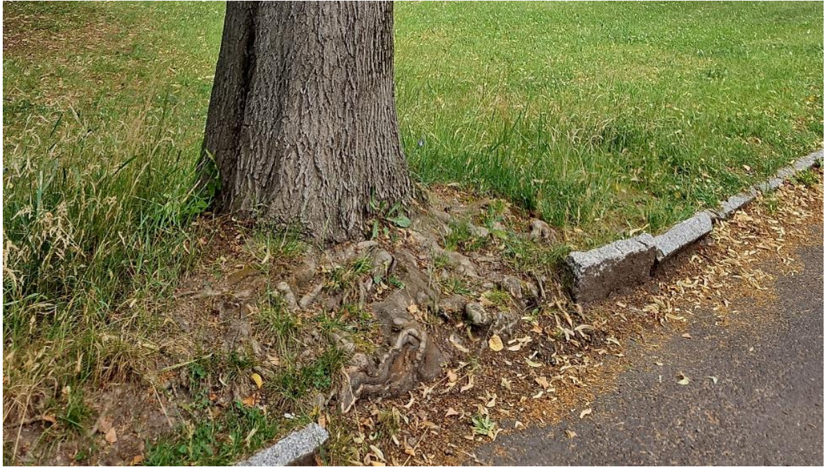
Foto 5 Baum A296 oberflächennaher Wurzelverlauf
