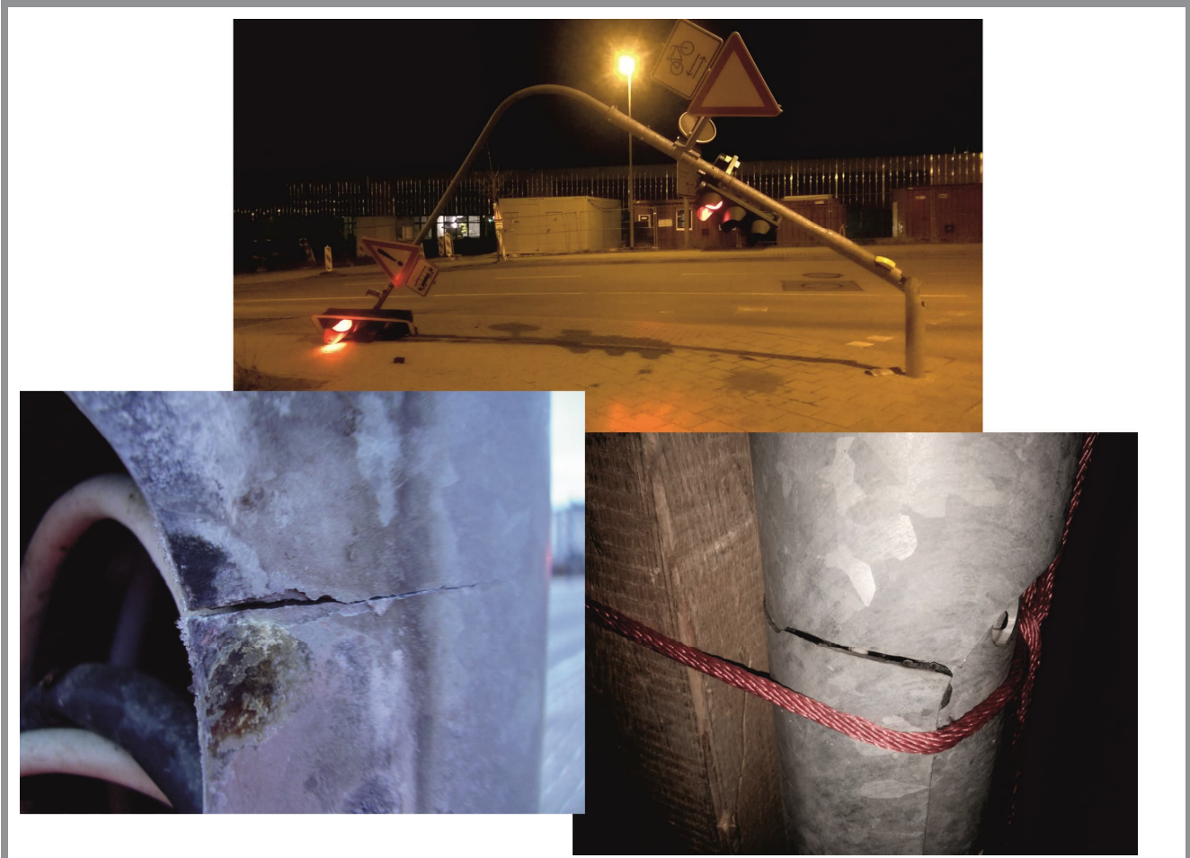
Abbildung 13: Fotos von Schäden an LSA-Auslegermasten in Erfurt
