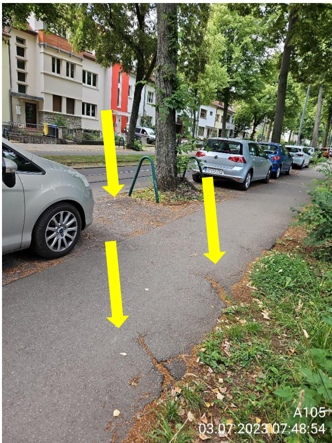
Foto 2 Baum A105 oberflächennaher Wurzelverlauf vermutet
