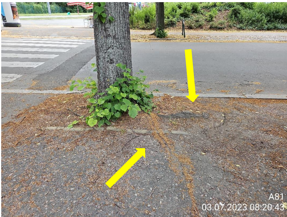
Foto 4 Baum A81 oberflächennaher Wurzelverlauf vermutet
