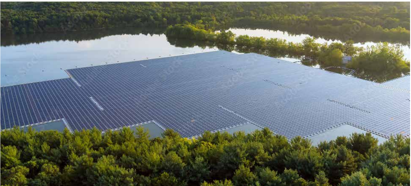
Abb. 172 Schwimmende Solaranlage, Bild: Ungvar - stock.adobe.com (lizensiert)
