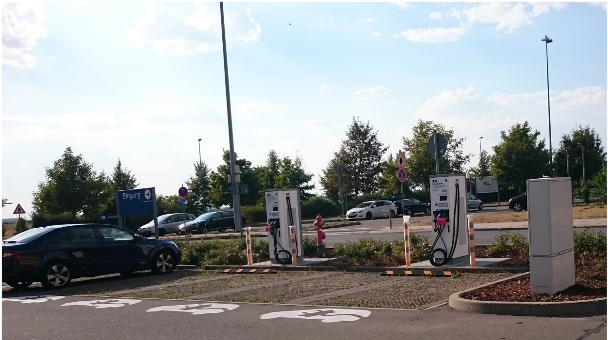
Foto 2 Halböffentliche Schnellladesäulen auf dem Parkplatz des Einrichtungsmarktes IKEA
