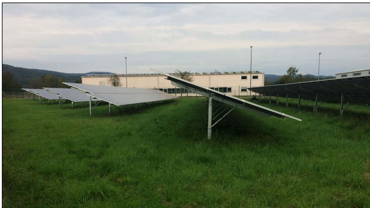
Abb. 5 und 6: Beispiel für bodenschonend aufgestellte Photovoltaik-Elemente
