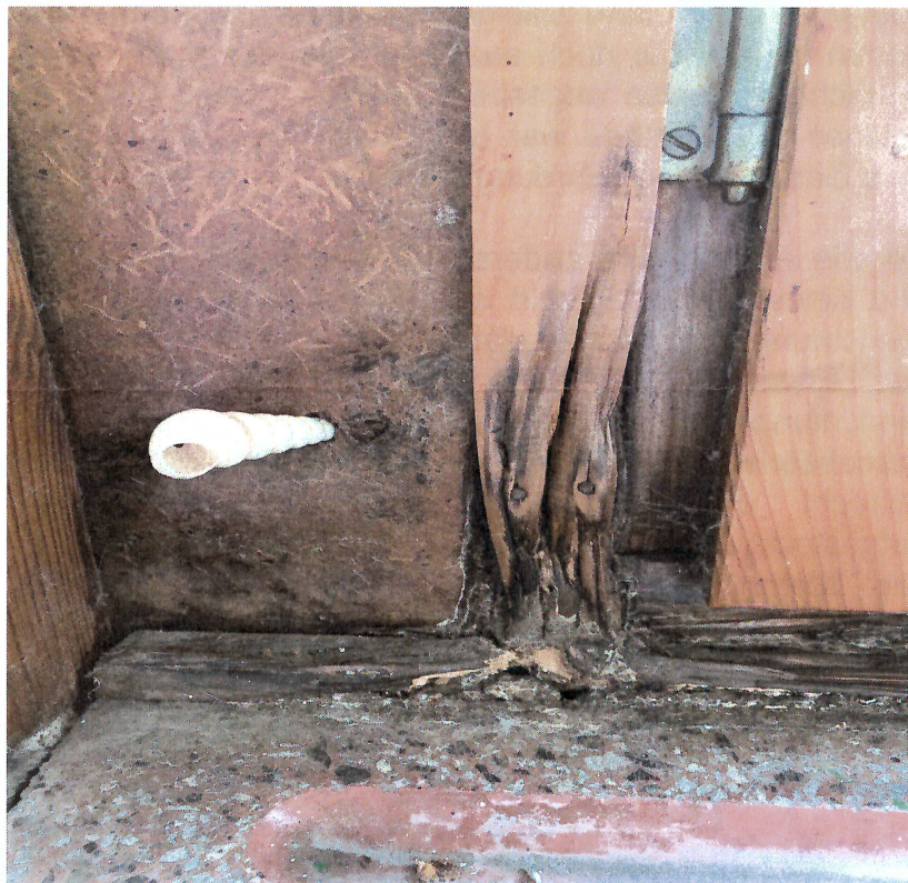
Foto 1: Fenster im Waschraum, 1. OG links, aufgenommen 02/2020
