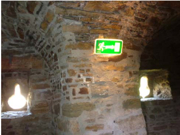
Abb. 8: Die Fluchtwegebeleuchtung in Ravelin Anselm leuchtet permanent und strahlt ungünstiger Weise sehr hell in den Gang.
