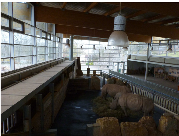
Abbildung 50: Betriebsgang an der Südseite, Lüftung darüber, abgehängte Beleuchtung, Heizkörper über Besuchergang
