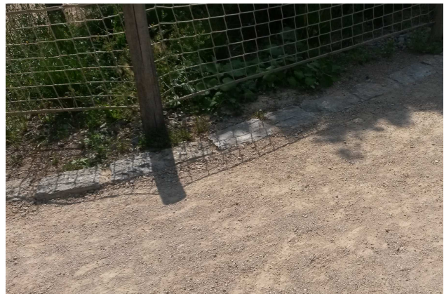
Abbildung 35: Erosion entlang des Randpflasters am Weg bei den Elefanten
