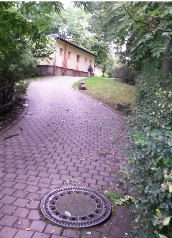
Abbildung 17: Steilstück in schlechtem Erhaltungszustand. Im Zuge einer Sanierung soll ein flacheres Gefälle hergestellt werden.
