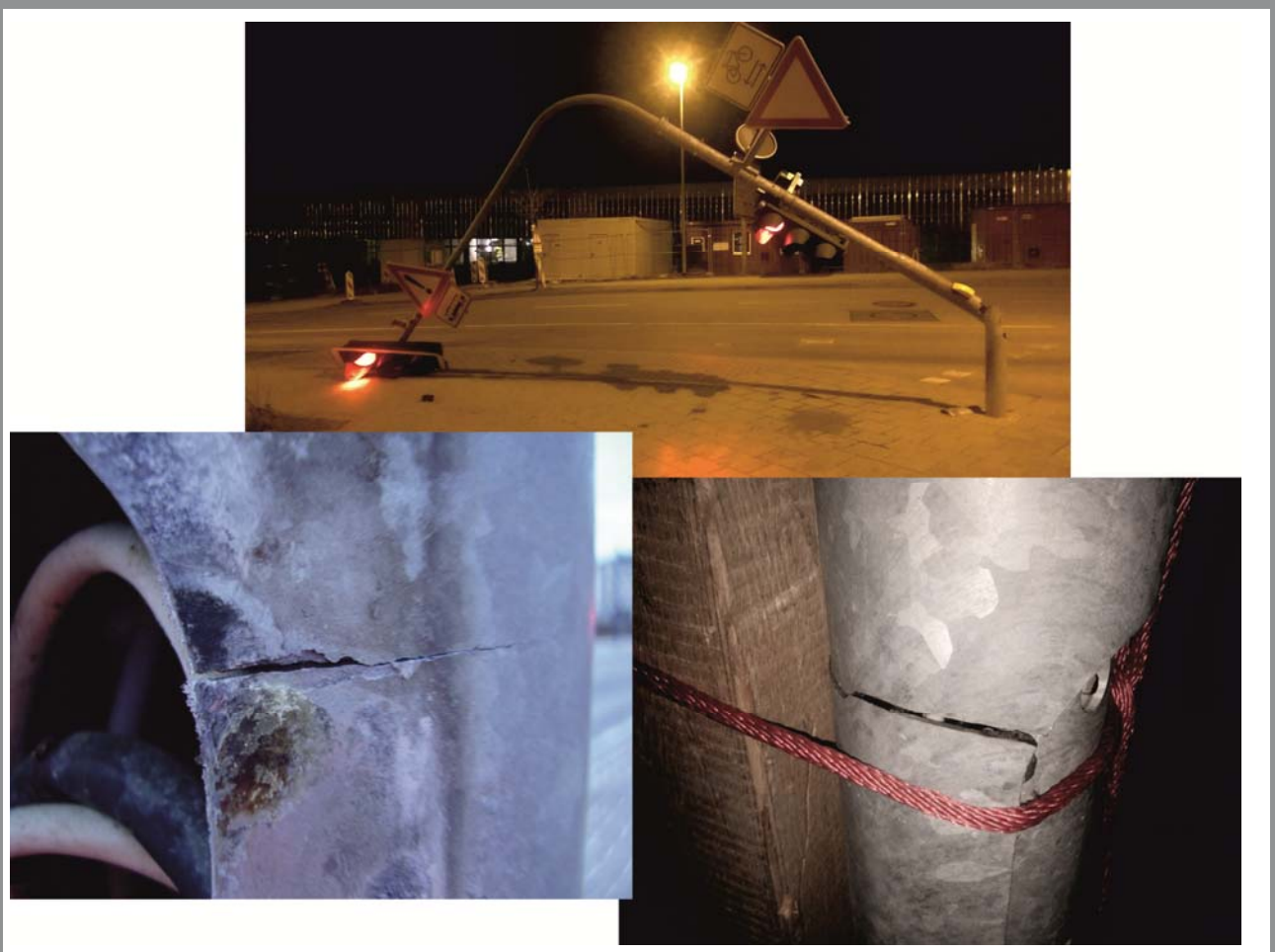
Abbildung 17: Fotos von Schäden an LSA-Auslegermasten in Erfurt
