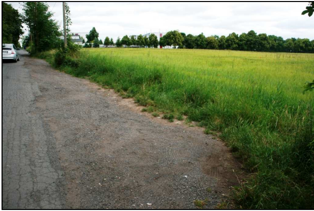
Abb. 14. Die Straße am Brühler Herrenberg ist in einem desolaten Zustand. Durch die Friedhofsbesucher werden die Randbereiche "wild" beparkt, wodurch Schäden an Vegetation und Boden hervorgerufen werden.
