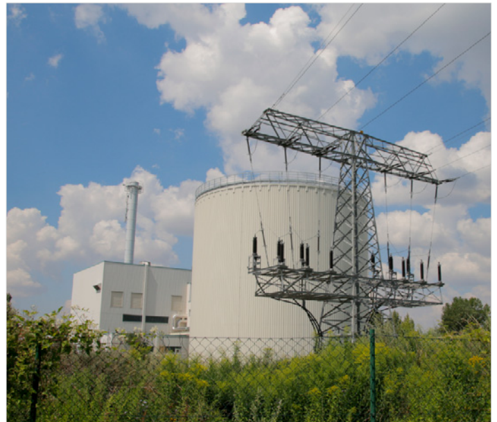
Heizkraftwerk mit Wärmespeicher
