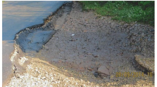
2: Abgebrochener Wegrand durch Ausspülung
