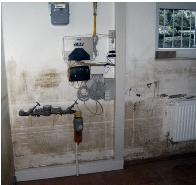
3: Schäden an der Elektrik und Heizungen
