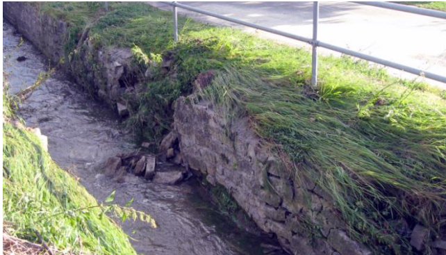
1: Ausgespülte Steine im Böschungsbereich
