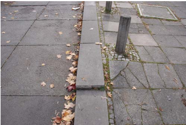
Unfallgefahren durch alte und gebrochene Wegebeläge
