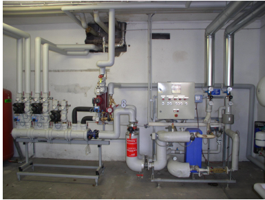
Bild links: Johannesplatz, neue Hausanschlussstation
