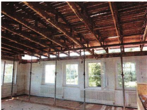
alte, statisch verwerfene Dachkonstruktion
